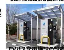
EVバス充電施設の設置
